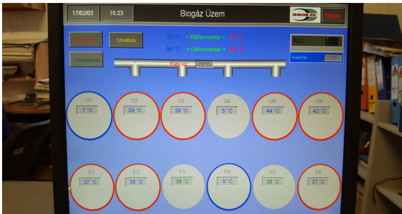
3. kép: A bioreaktorok automatikus fűtésvezérlése (Nyírbátori Regionális Biogáz Üzem, 2016)
