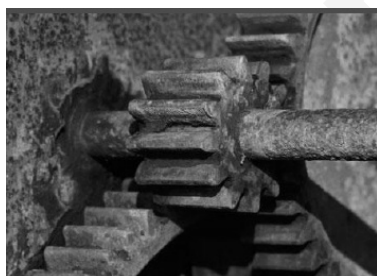
34. ábra. Korrodált fogaskerekek
