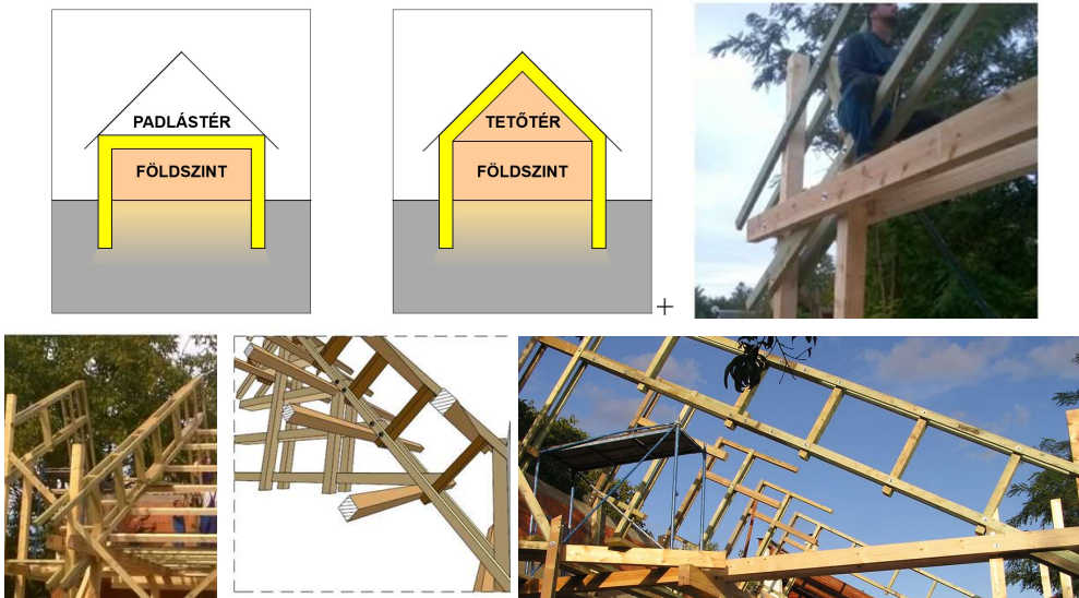
35. ábra. Balra fent: A hőszigetelés vonalvezetésének sémaábrája beépítetlen és beépített tetőtér esetén. Jobbra fent és lentiek: Beépített tetőteres épület szalmabálával szigetelt ferde tetősíkjához kifejlesztett tetőszerkezet 3D-s modellje és megvalósult képei. (Igaz, 2017a) (Igaz, 2018)
