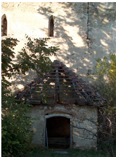
6. kép Függőleges repedés a déli oldalon
