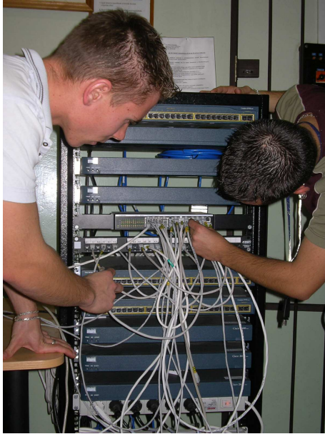
2. ábra: Rack állványon elhelyezett hálózati eszközök
