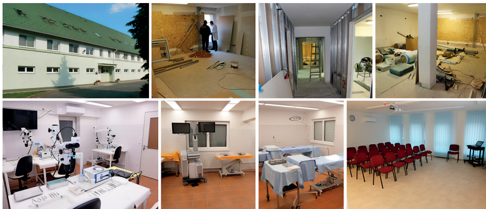
Válogatás a Sebészeti Műtéttani Tanszék „A” épület bővítésének munkafolyamatáról és az elkészült új helyiségekről készített fotókból
