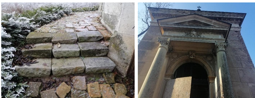
34. ábra: A kápolna burkolatai felújítás előtt (forrás: saját fotók 2021.)
