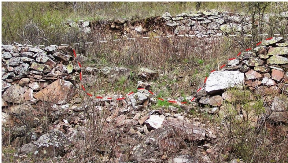
30. ábra Alapig leomlott támfalszakasz a tokaji Nagy-hegyen
