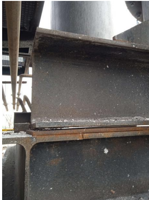
1. tartógerenda és az I-gerenda közötti hézag, amire a berendezés támaszkodna
